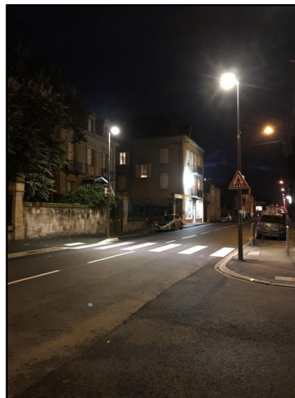
Eclairage d'un passage piétons Bd Roosevelt
