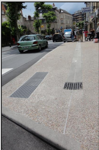
Grille sur quai bus Bd Anatole France
